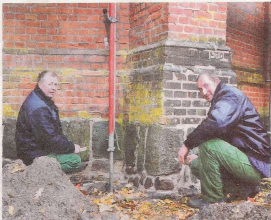
Thomas Moldt (l.) und Tobias Krüger vom Bauunternehmen Rogmann aus Parchim haben einen Abschnitt am Fundament der Kirche saniert. FOTO: HEIDRUN PÄTZOLD
