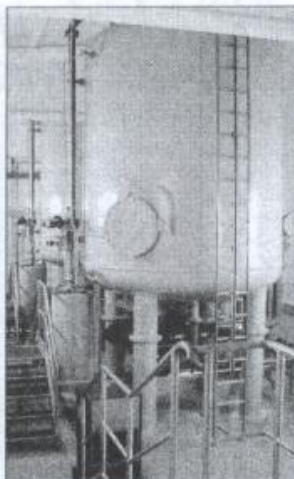
Sandfilteranlage im Wasserwerk
