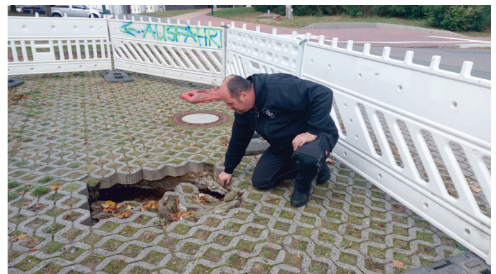
Bürgermeister Klüver inspiziert das Loch auf der Parkfläche.
